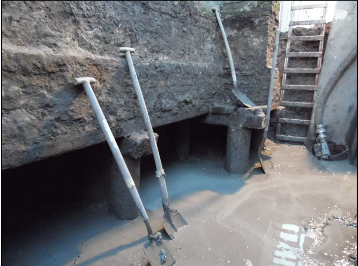
Afbeelding 10. De noordwestelijke hoek van het kerkgebouw. Op de foto zijn de wateroverlast en modder duidelijk zichtbaar.
