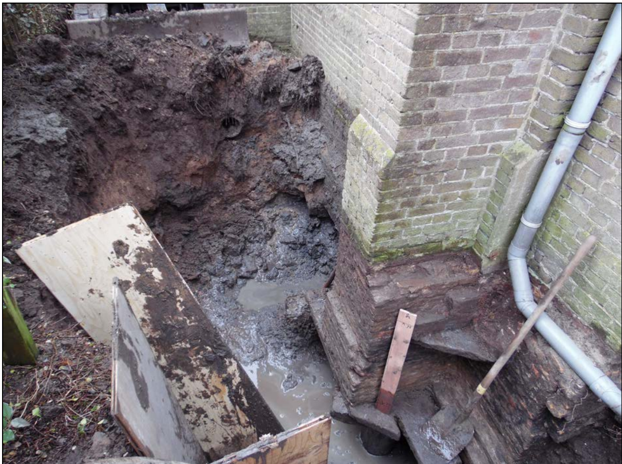
Afbeelding 9. De noordwestelijke hoek van het kerkgebouw. Op de foto zijn de wateroverlast en modder duidelijk zichtbaar.
